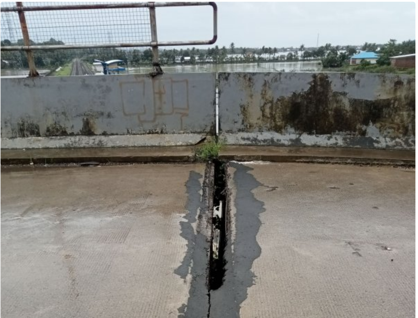
Sambungan jalan fly over Pekkae rusak parah
