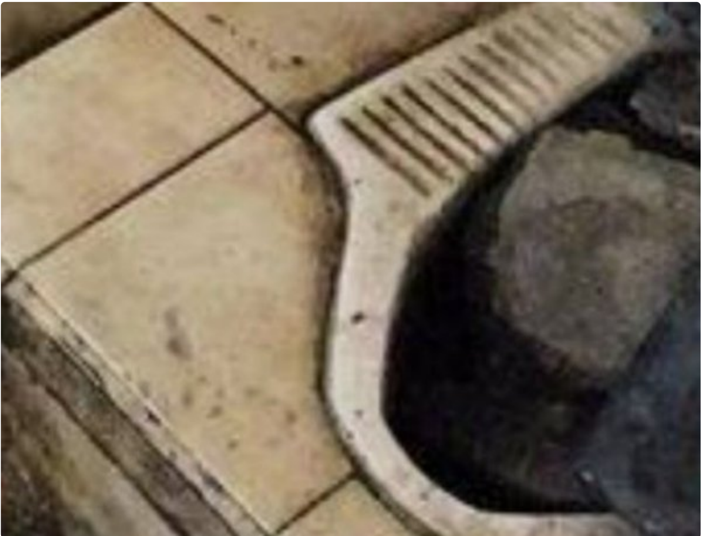
Toilet pasar rusak seperti ini, penjual dan pembeli mengeluh
